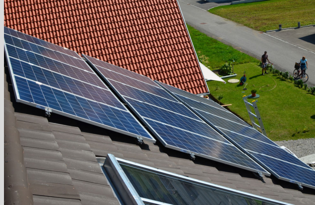
Hinterlüftung kühlt die Module
